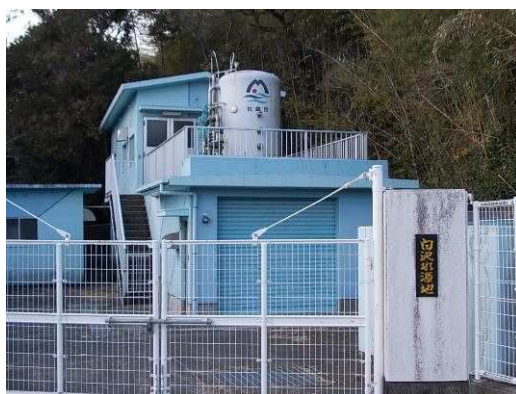
硝酸態窒素除去装置：白沢ポンプ場
