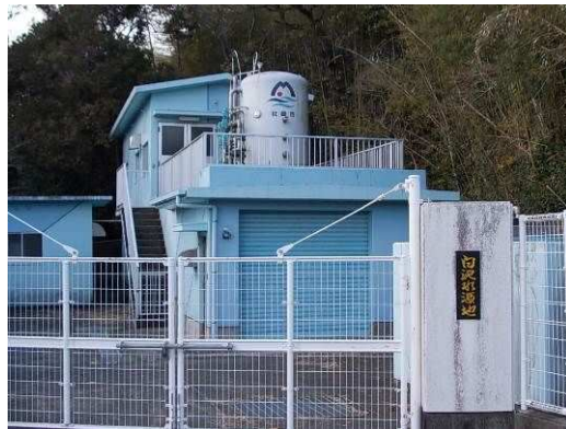
硝酸態窒素除去装置：白沢ポンプ場
