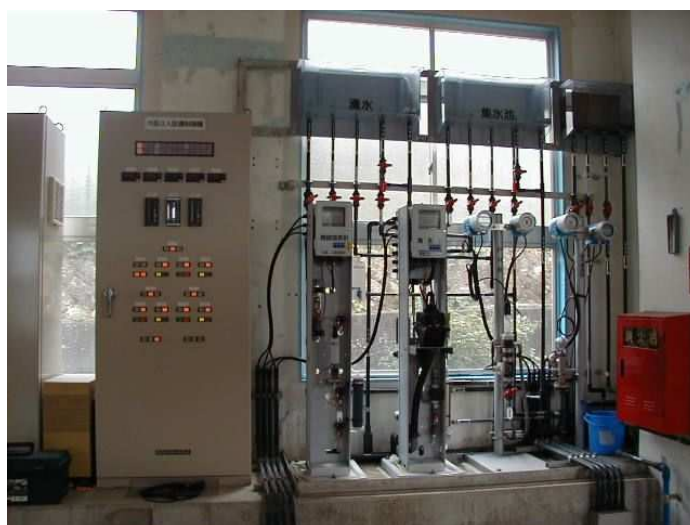
水質計器（濁度計・残留塩素計・PH計・導電率計）
