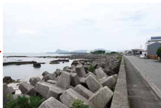
▲平成27年度の台風15号で高潮の被害を受けた新町・旭町地区の枕崎漁港海岸護岸整備の事業化に向けて取り組みます。
