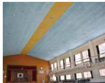
▲小・中学校の屋内運動場等における非構造部材の耐震化を集中的に実施します。
