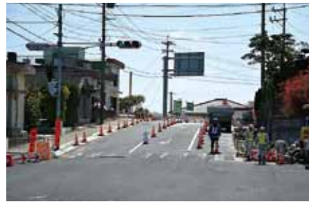
▲坂道でカーブの多い中原工区(写真)は現在改良工事を行っています。
