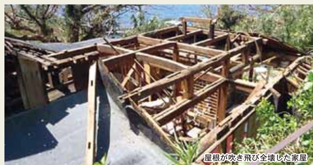
屋根が吹き飛び全壊した家屋
