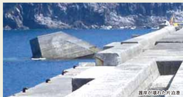
護岸が壊れた片泊港
