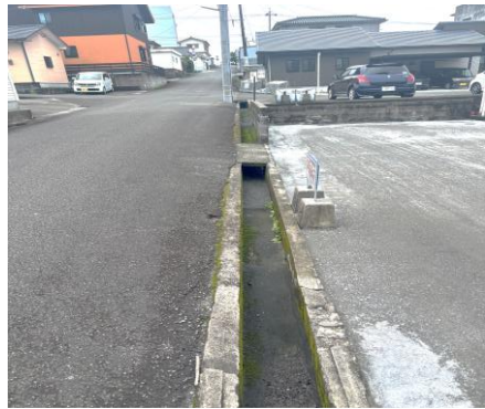
【緑町の側溝】 ・蓋がなく、増水時に危険あり。
