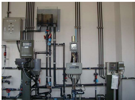
金山浄水場 水質検査計器
