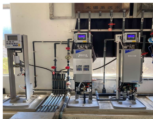
深浦ポンプ場 水質検査計器
