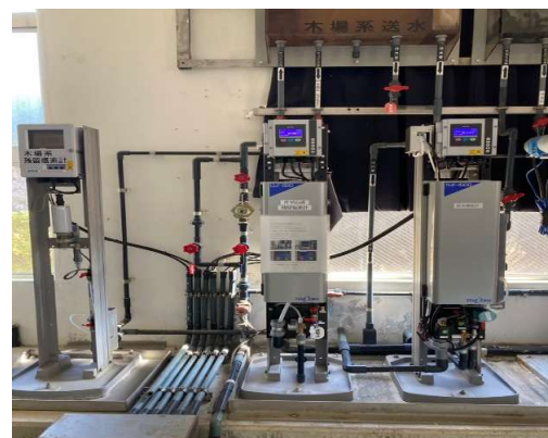
深浦水源地濁度計・残塩計
