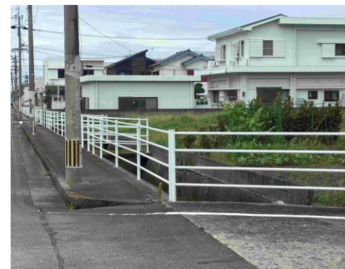
【日之出公園付近の川(側溝)】 ・川の柵の幅が広いので、滑ったときに事故につながる恐れ。
