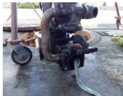
▲汚水ポンプに引っかかったタオル
