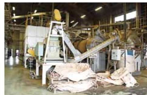
▲「浜の活力再生施設整備事業」により、残さい再資源化処理施設を新たに整備します。
