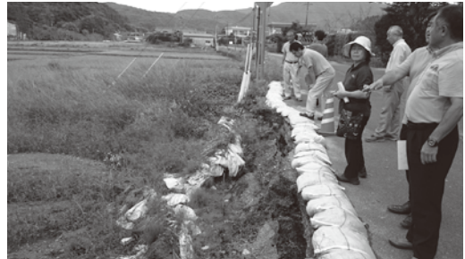
災害箇所の調査
